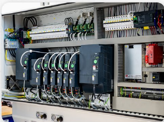
Szafa elektryczna – komponenty
